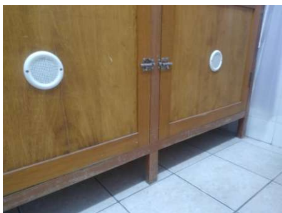
Armário com necessidade de troca
