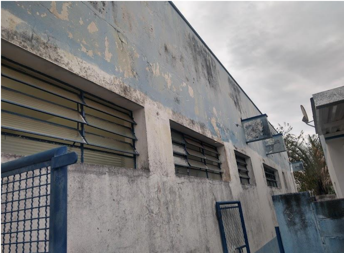
Unidade com péssima pintura externa
