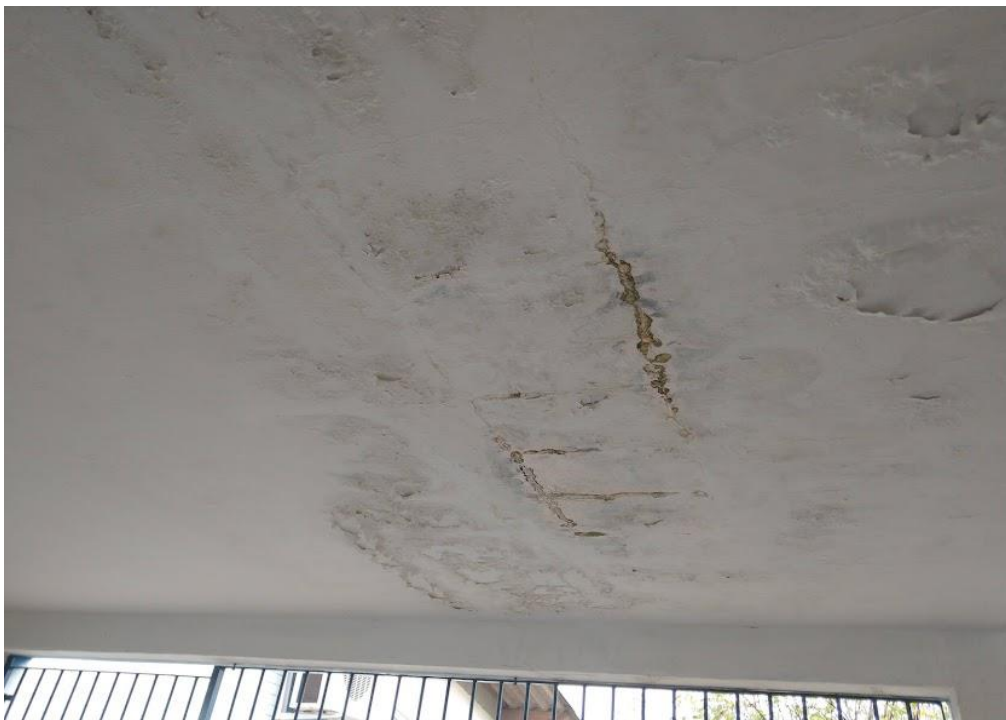
Teto com infiltração
