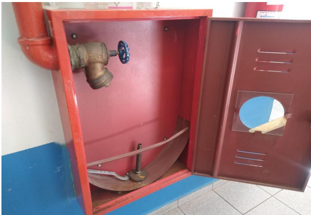
Ausência de mangueira no hidrante
