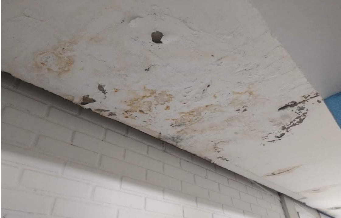
Teto com infiltração
