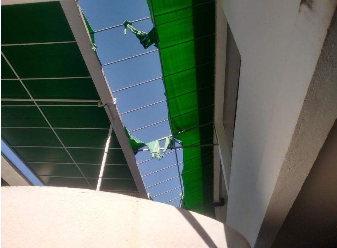
Toldos danificados, com necessidade de troca
