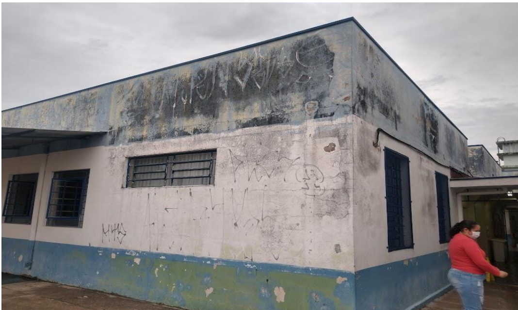
Unidade com péssima pintura externa
