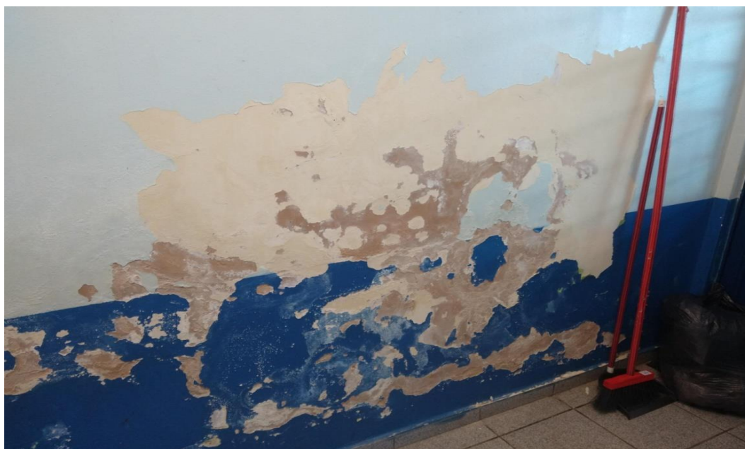
Paredes com sinais de infiltração
