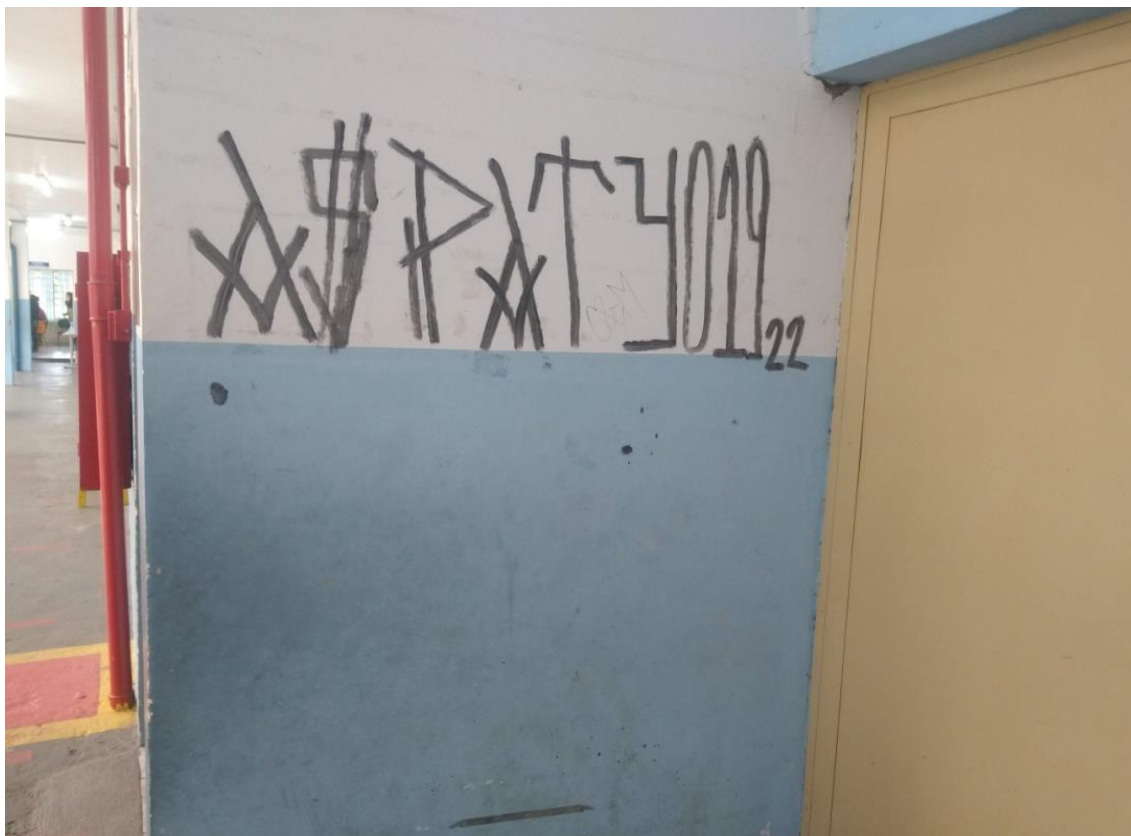
Paredes com sinais de vandalismo e com desgaste na pintura
