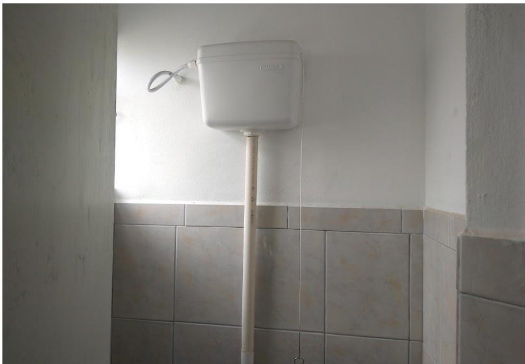
Banheiro infantil com descarga inadequada
