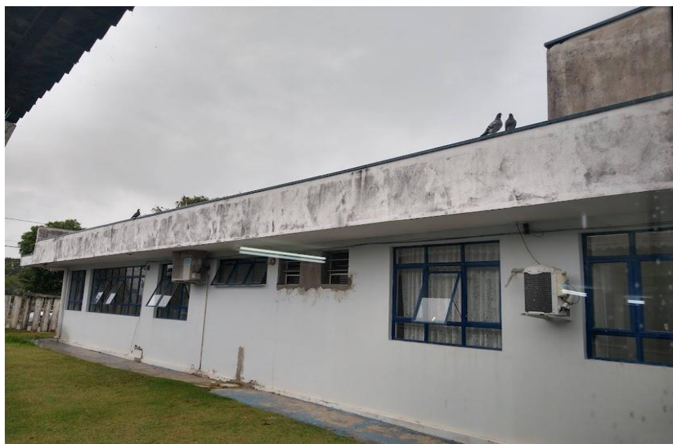
Escola com necessidade de reforma
