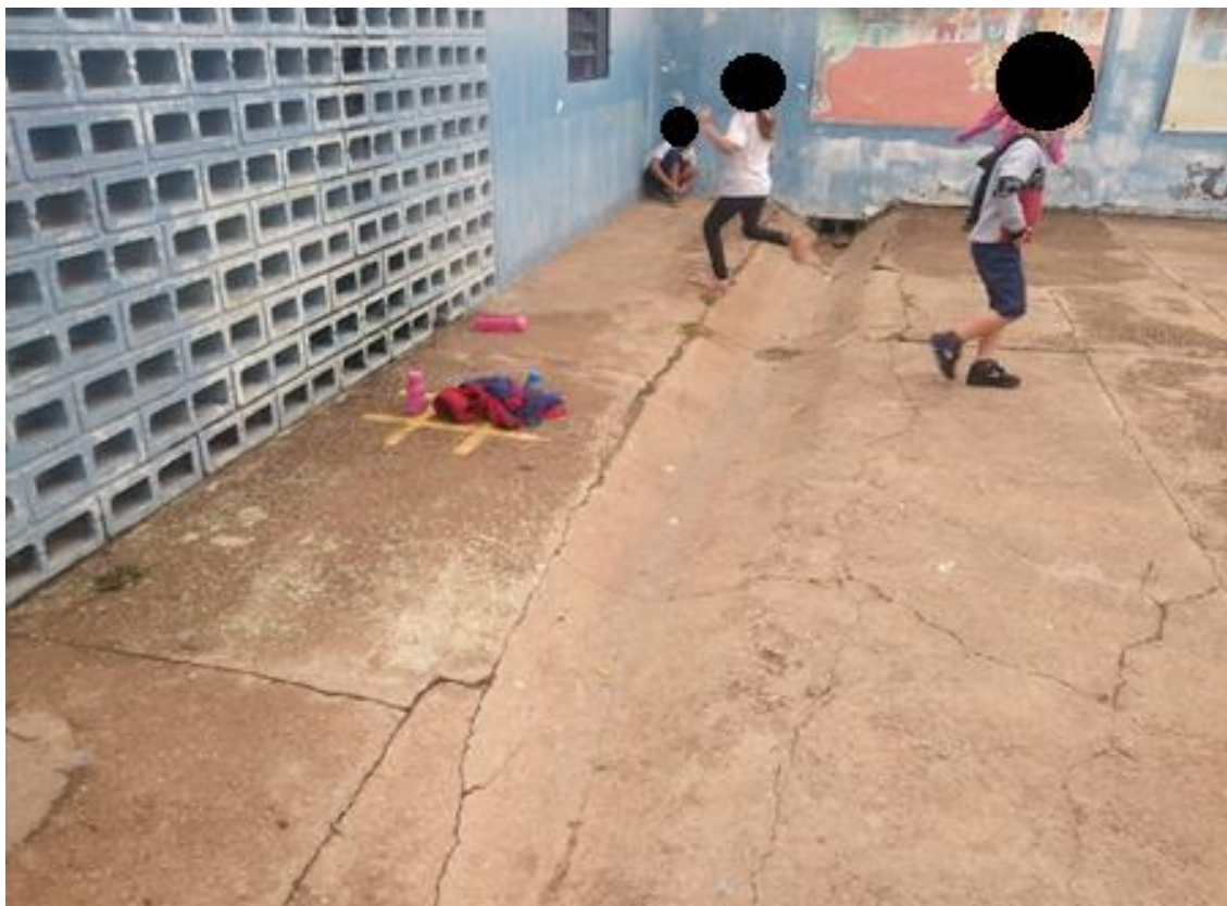
Pátio de recreação inadequado – irregularidades no chão
