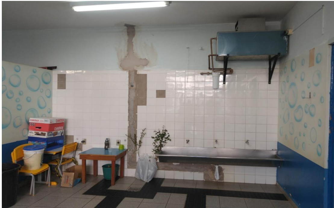
Necessidade de colocação de azulejos no lavatório
