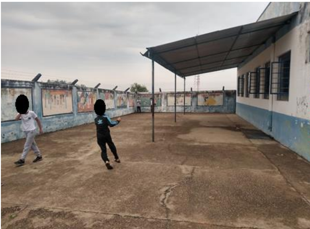
Pátio de recreação inadequado
