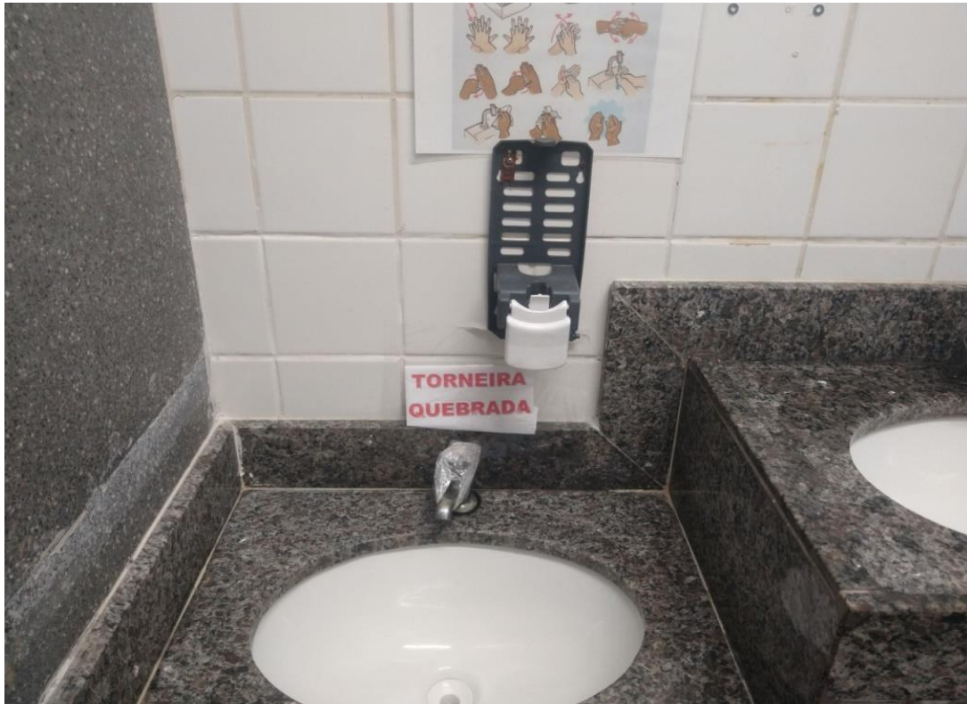
Torneira quebrada no banheiro
