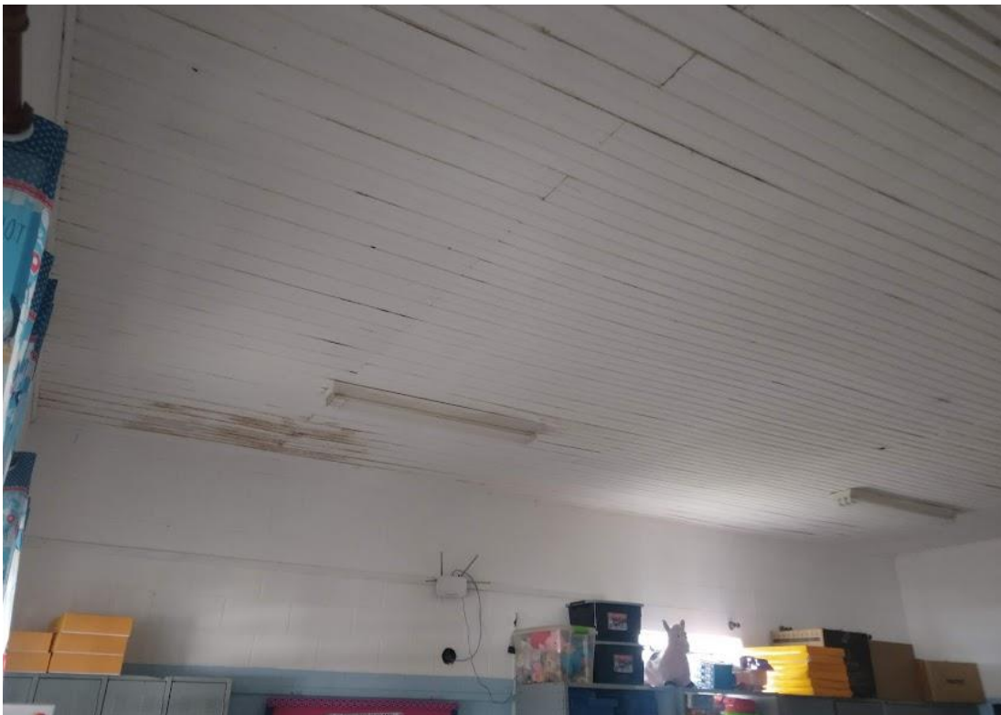
Teto de madeira com infiltração
