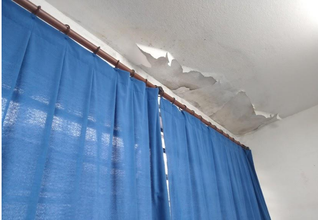
Sala de aula com infiltração
