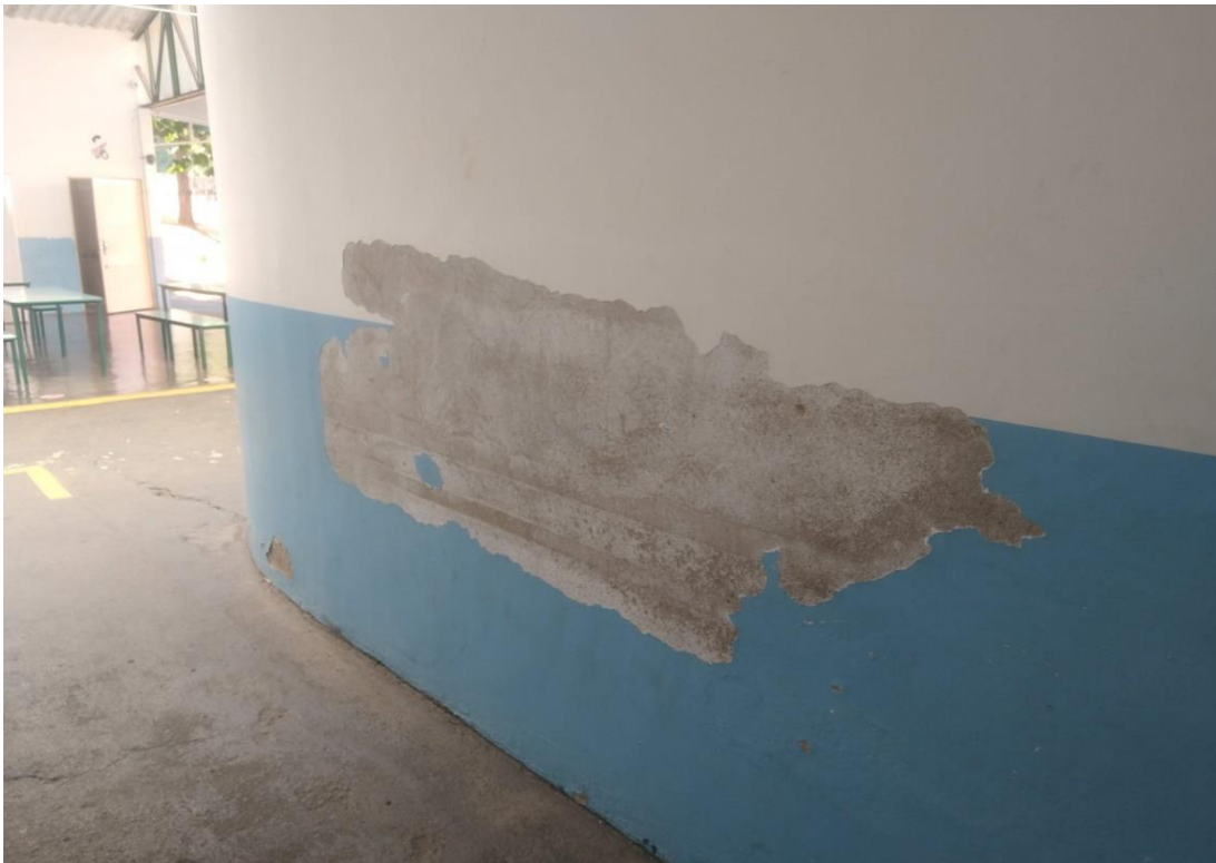
Paredes com sinais de desgaste: necessidade de pintura
