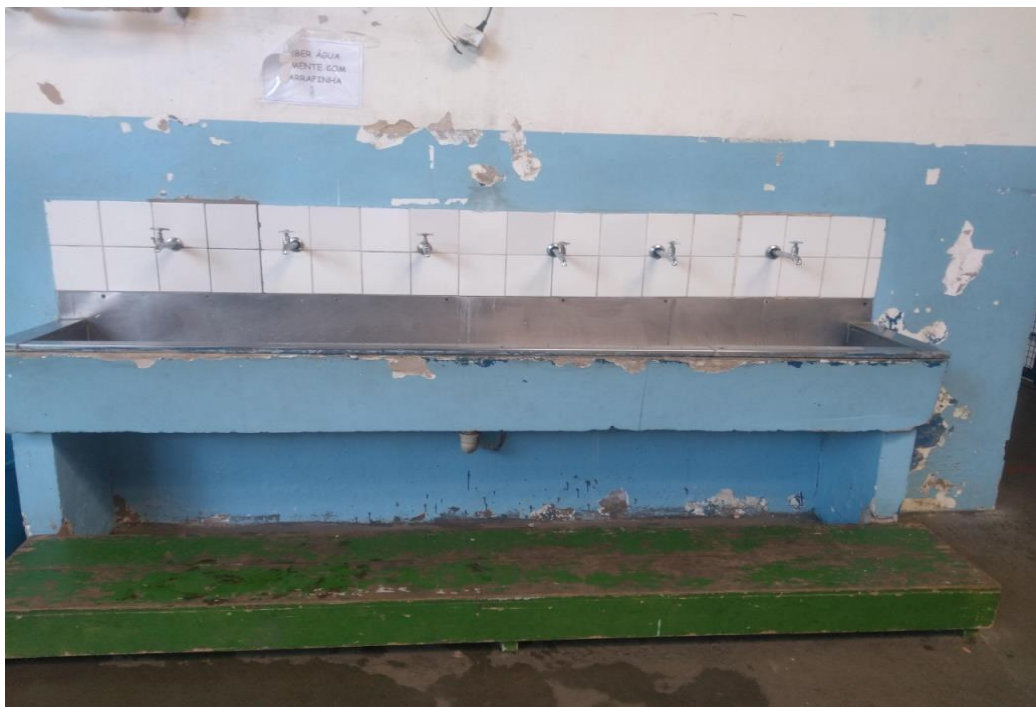
Bebedouro com necessidade de reforma
