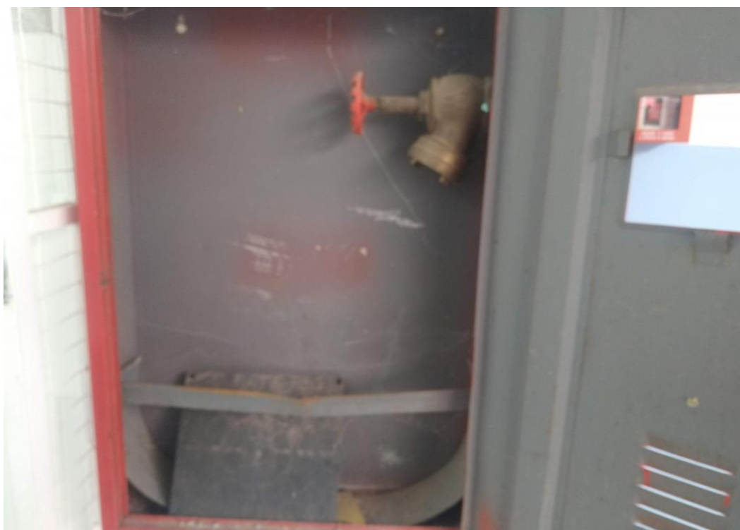
Ausência de mangueira no hidrante
