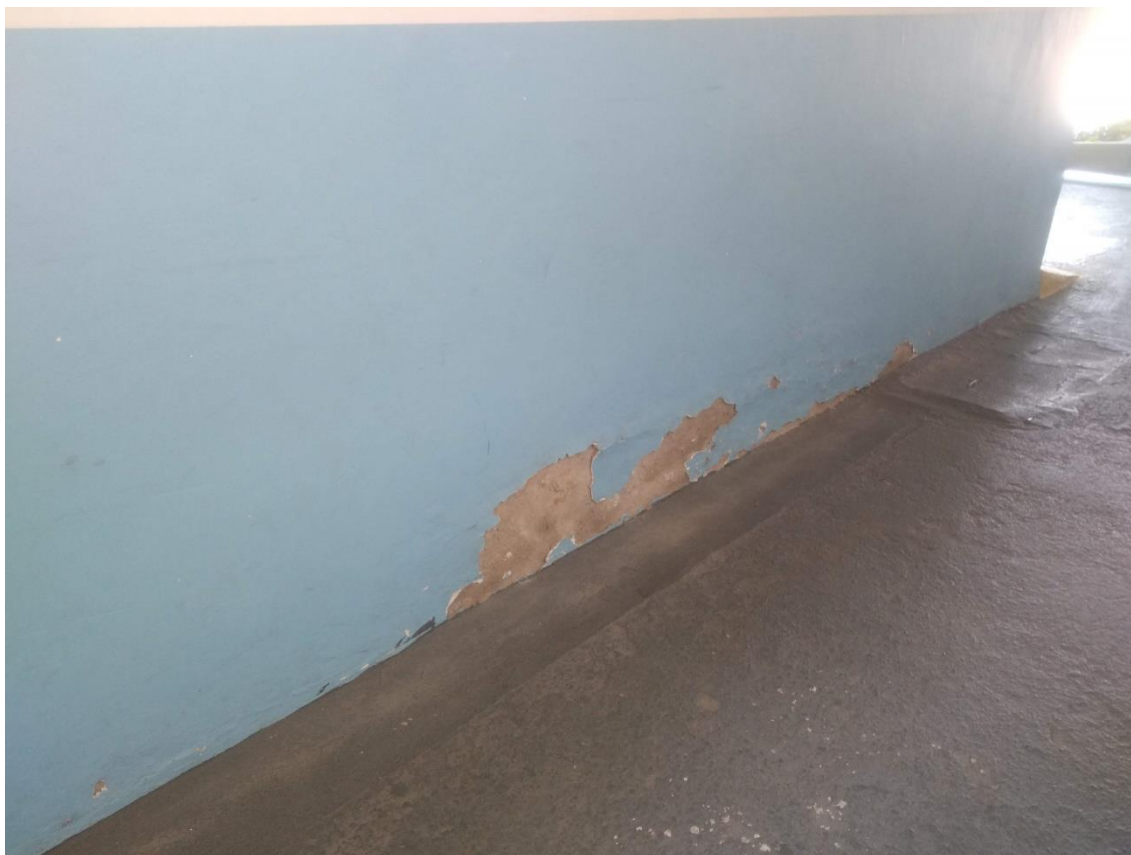
Paredes com sinais de desgaste: necessidade de pintura
